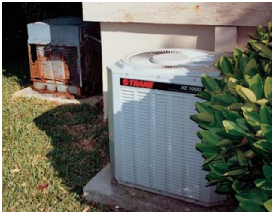
El viejo y el nuevo — ¡todavía funcionando y funcionando! Un modelo Trane de 1987 muestra corrosión galvánica, más no da muestras de corrosión por separación del serpentín debido a los metales similares y al adhesivo de unión.. Además, se observa una segunda unidad XE 1000 1994 perfectamente reluciente.
